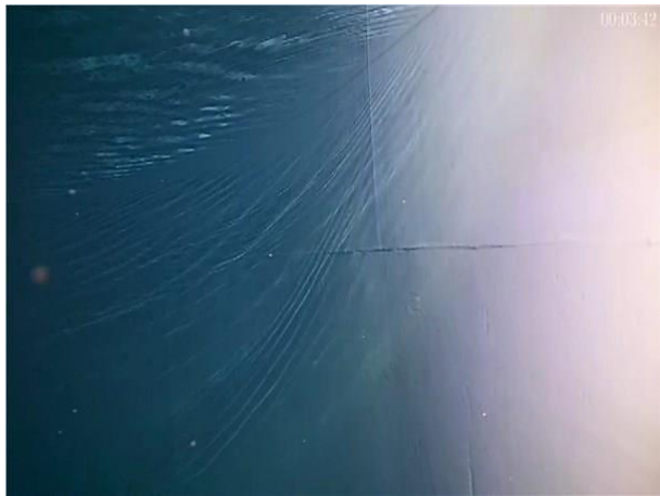
25) 03:45 Shell weld seam
